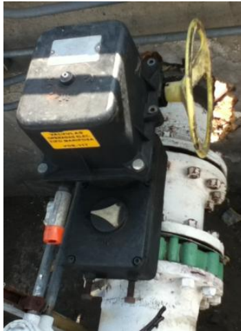
Figura III.5: Estado actual de los actuadores
