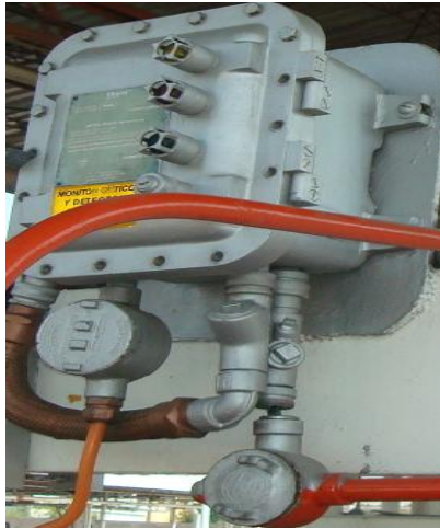
Figura III.3: Estado actual de detectores de tierra y sobrellenado
