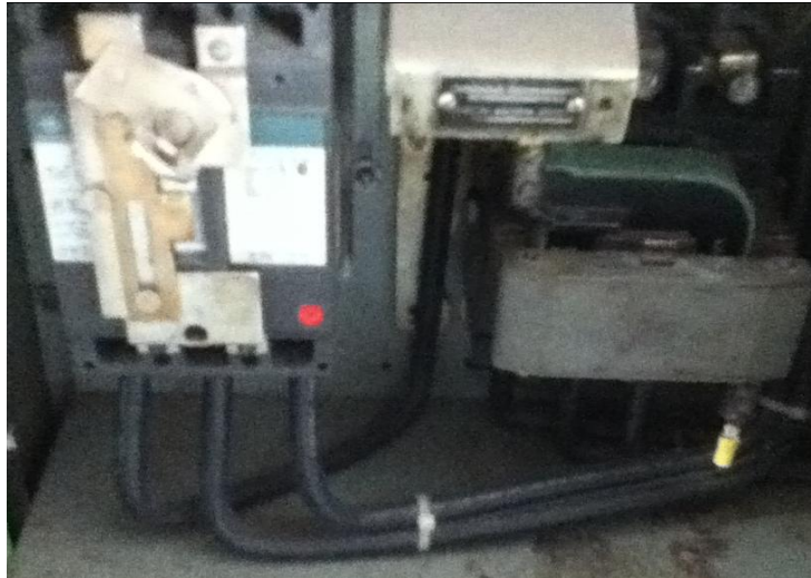
Figura III.9: Estado actual los arrancadores para bombas de proceso
