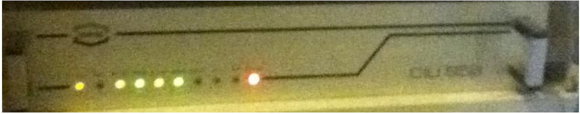
Figura III.8: Estado actual UCL de telemedición
