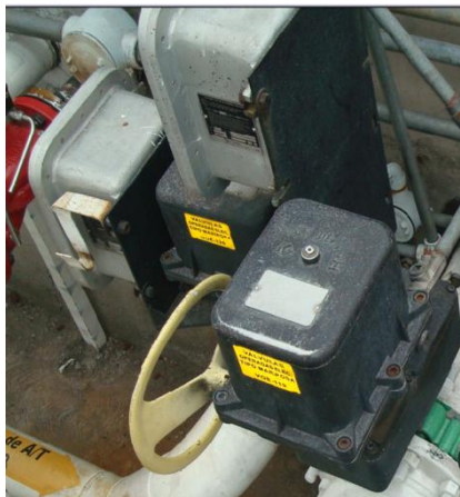
Figura III.6: Estado actual de los actuadores y botoneras
