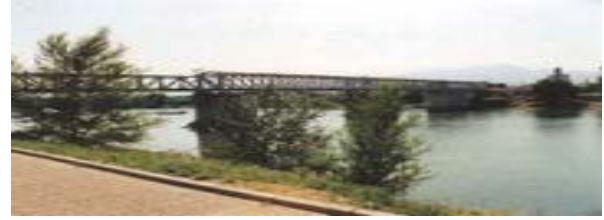
Fig. 3.4.6 El puente del ferrocarril sobre el río Ebro a la altura de Tortosa es principalmente una celosía Pratt con algunas variaciones particulares http://es.wikipedia.org/wiki/Imagen:Spain_Ebro_river_in_Tortosa.JPG
