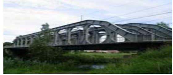
Fig. 3.4.8 Un puente en Grammene, Bélgica , de celosía Vierendeel reforzada en las uniones. http://es.wikipedia.org/wiki/Imagen:Grammene-vierendeelbridge_20030618.jpg
