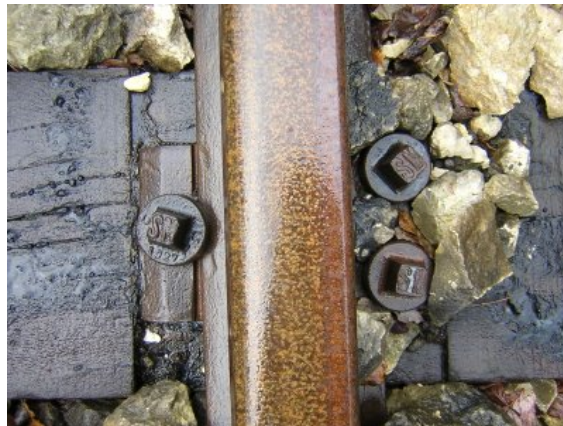
1.3.13 Riel fijado con tirafondos 63
