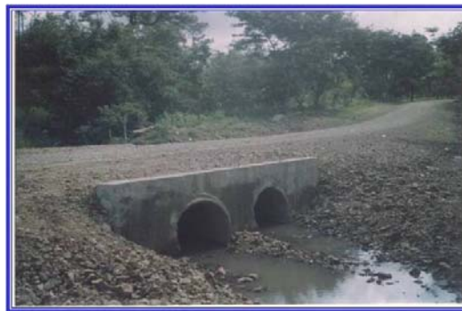
FUENTE: http://ingmurillomartinez.com/carretera_cort_s.jpg Detalle de Tubos de drenaje en Carretera del Estado de Oaxaca, México.
