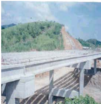
Fig. 3.3.2 construcción de los puentes de concreto Cuauhtémoc y paso del toro (km. 87+036) de la vía del ferrocarril México-Veracruz, tramo Cd. Mendoza-sumidero para PYASA ingenieros civiles, s.a. de C.V., ref.: Ing. Daniel castro nuño. HTTP://WWW.GOOGLE.COM.MX/SEARCH?SOURCEID=NAVCLII8&RLZ=1T4GGIK_ESMX286MX289&Q=PUENTES+DE+CONCRET+O+PARA+FERROCARRILES
