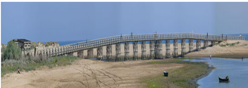
3.1.2.2 Puente de madera que une a del Caimán con la Playa de las tas, en Isla Cristina, provincia de Huelva.
