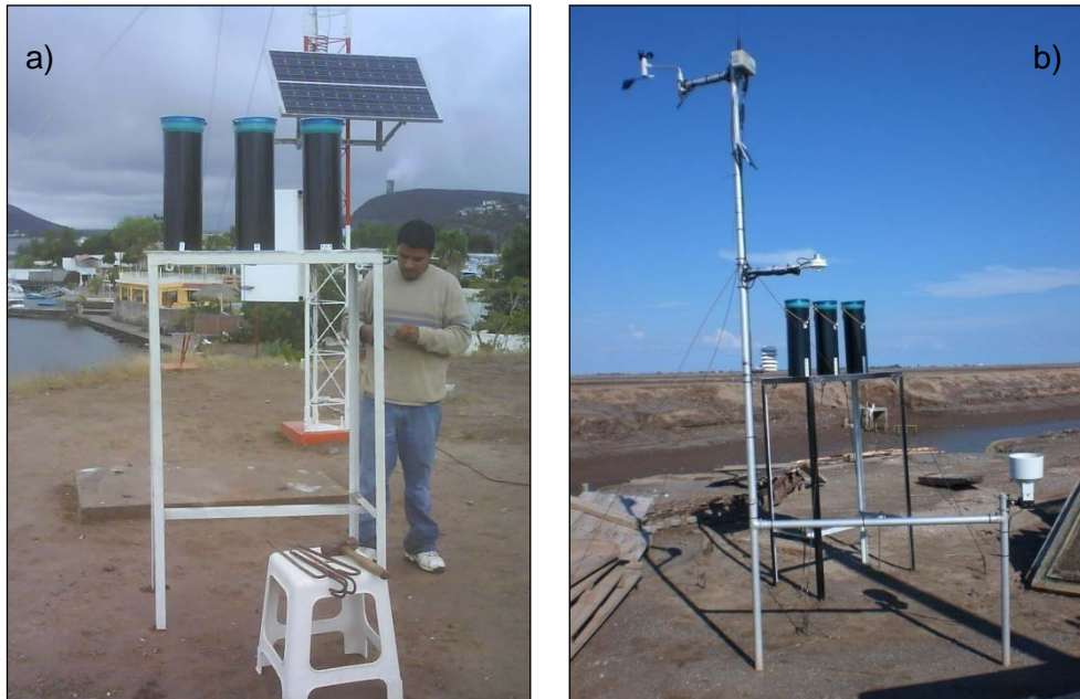
Figura 9. Instalación de los pluviómetros en dos sitios en Sinaloa: a) Topolobampo y b) El Tortugo (Navachiste).
