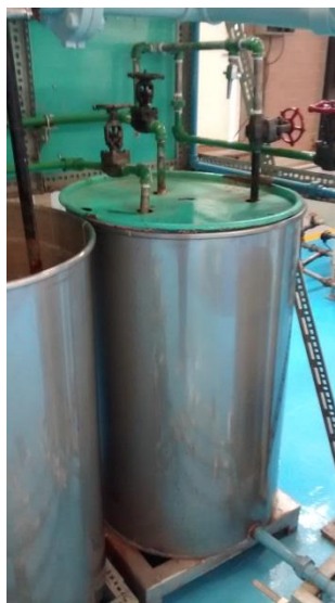
Figura 3.7. Tanque de amoníaco, ESQIE-IPN.
