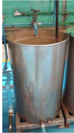
Figura 3.2. Tanque de alimentación de agua, ESIQIE-IPN.
