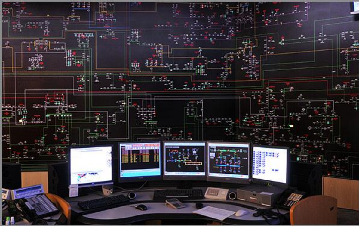
Fig. 2.2 Mapa electrónico en un centro de control [obtenido de Monitor Mapboard Systems ( http://www.mapboard.com/scadaboard.aspx )].
