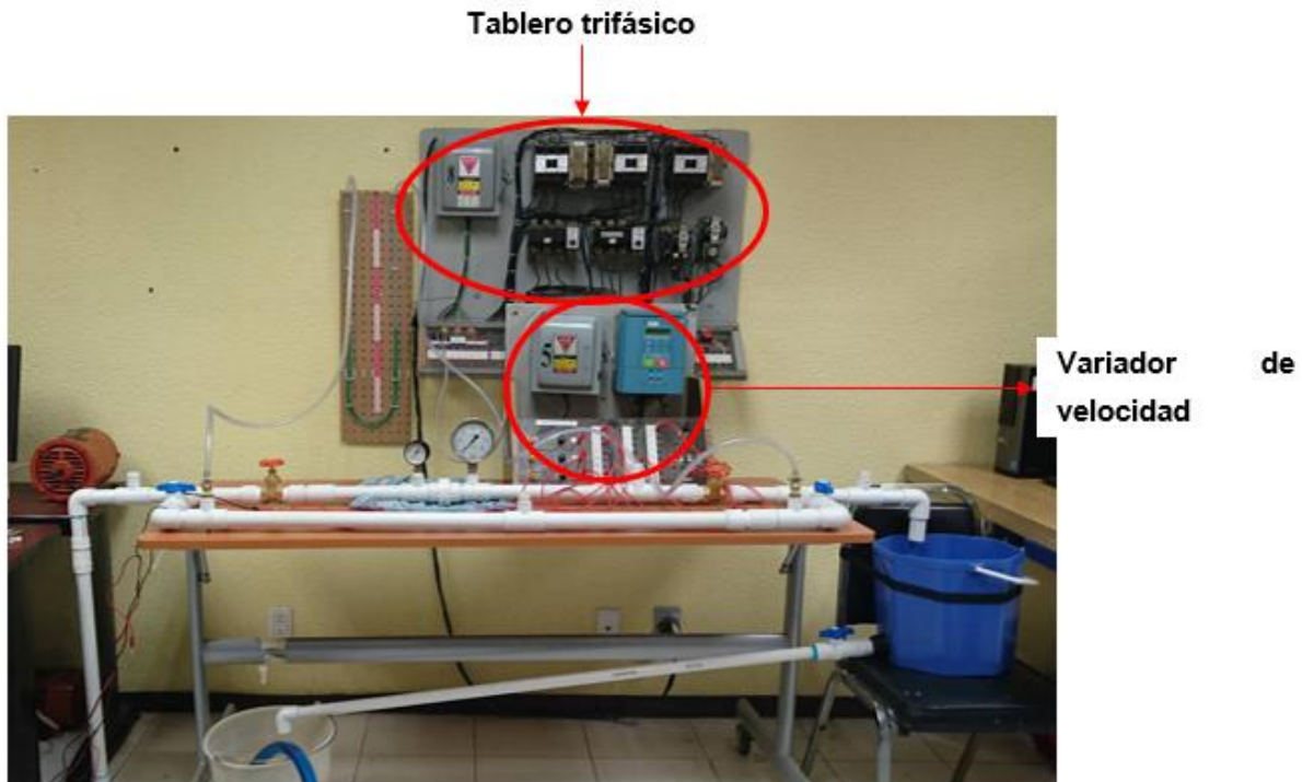
Figura 4.4 Conexión del prototipo al tablero trifásico de pruebas y al driver.
