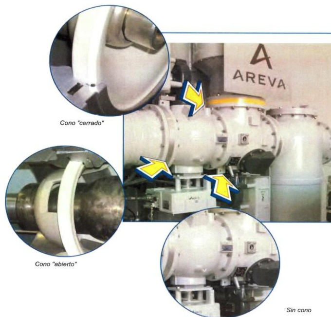
Figura 3.4. Identificación de los conos en una subestación blindada.
