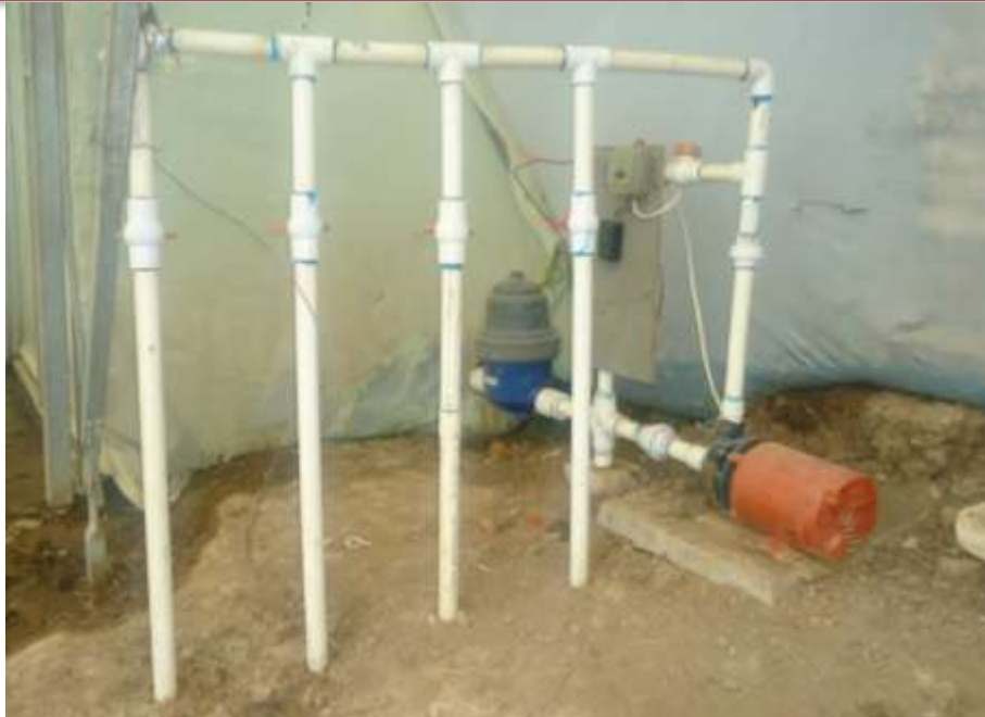
Figura 3.13 Sistema de riego.
