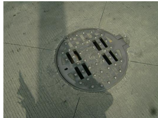
Pozo de visita
