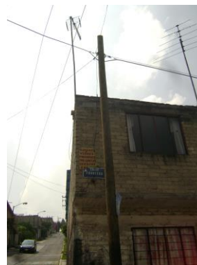
Poste de teléfono
