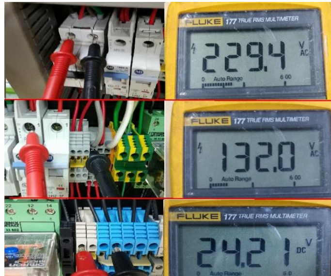
Figura 2-40. Mediciones de voltaje en tablero
