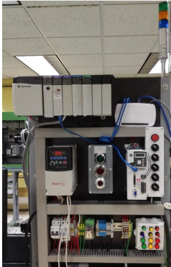
Figura 2-39. Tablero de control instalado
