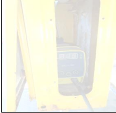
Figura 17. Bomba dosificadora. (Imagen modificada por confidencialidad).
