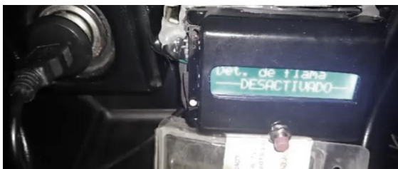
Figura. 53 Sistema desactivado (cofre abierto)
