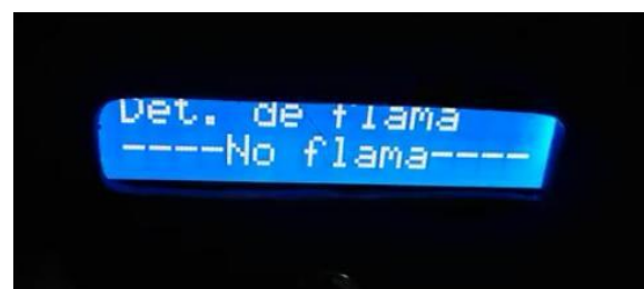
Figura. 54 Sistema activado (detección de fuego)
