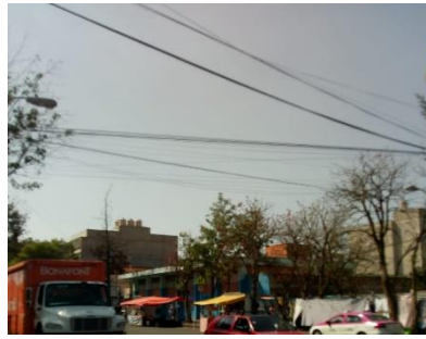
Ilustración 10 Cruce de los cables en la Av. Escuinapa
