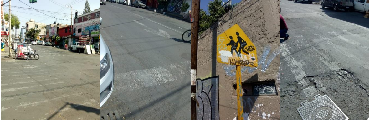
Ilustración 22 Se observa el deterioro y el vandalismo de las señalizaciones horizontales y verticales
