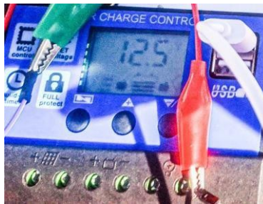
Figura 28. Batería totalmente cargada. (Imagen de autoría propia)
