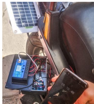
Figura 27. Prueba de recarga de la batería con poca radiación directa. (Imagen de autoría propia)
