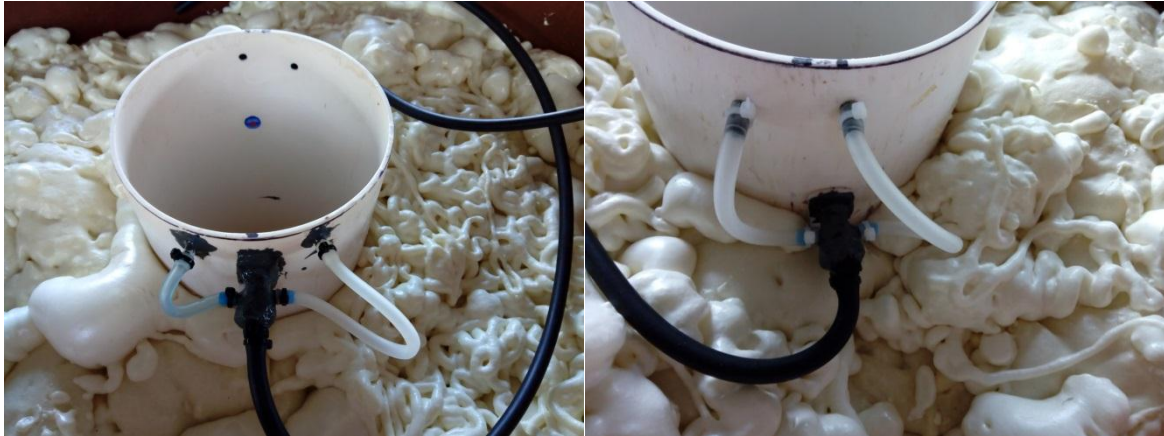
Figura 3. Respiradores de las boquillas y mangueras instaladas
