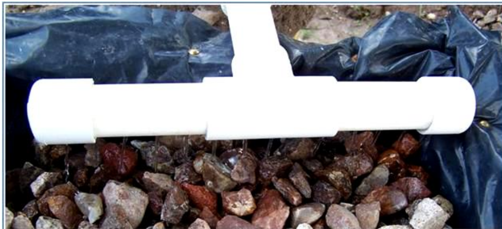
Figura V.26. Regaderas de distribución al humedal
