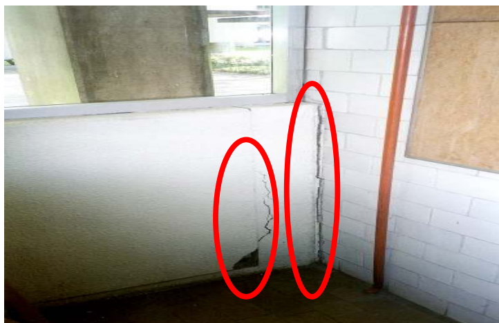
Foto 7. Grieta de un laboratorio del Edificio de Laboratorio Ligeros. Fuente: Propia
