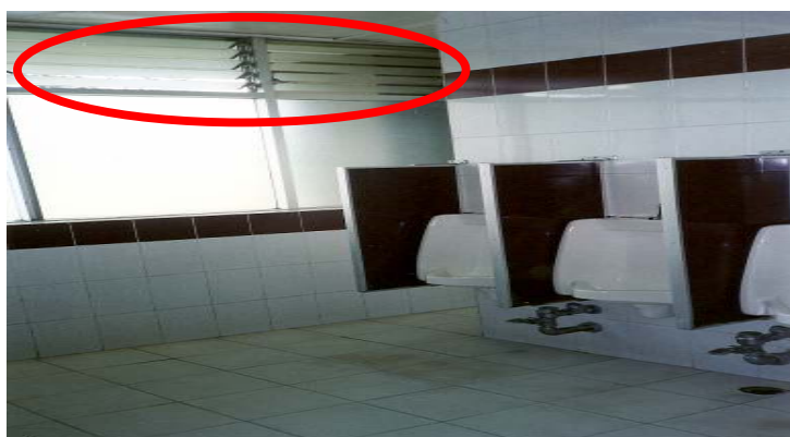
Foto 4. Baños de hombres del Edificio de Ciencias de la Ingeniería. Fuente: Propia.
