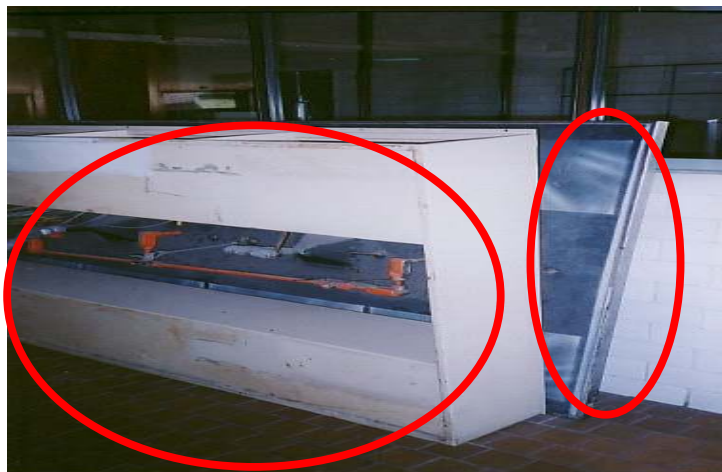
Foto 8. Equipo deteriorado, material extraño detrás de él. Laboratorio del Edificio de laboratorio Ligeros. Fuente: Propia.
