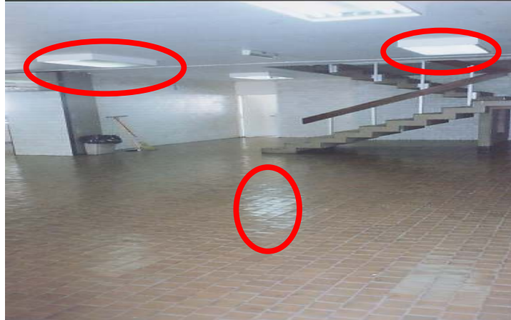
Foto 21. Pasillos con niveles de iluminación que sobre pasan los requerimientos. Fuente: Propia.
