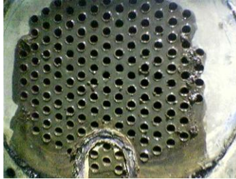
Figura 26 corrosión generalizada en el espejo del intercambiador por combinación de materiales.
