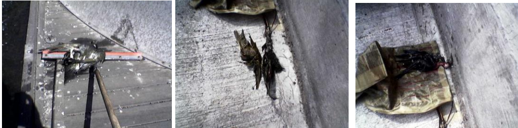
Figura 29, 30 y 31. Aves desalojadas del empaque de una torre de enfriamiento.
