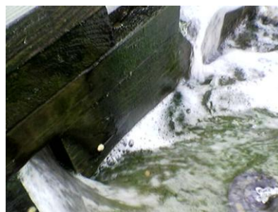
Figura 14 Crecimiento de algas en Torre.
