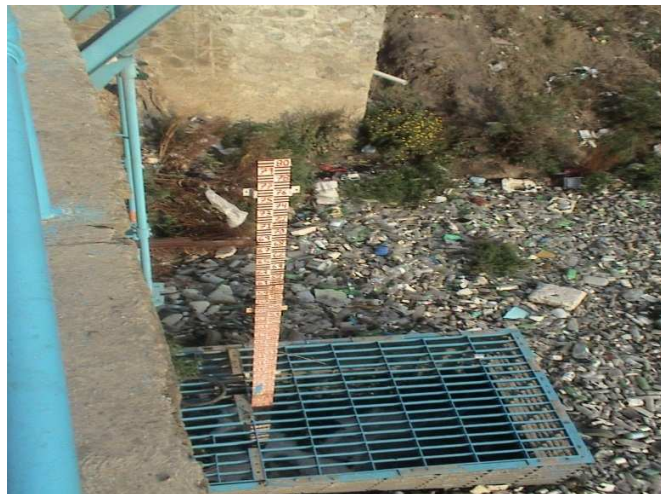
Fig. 5.2.3. Vista de la Presa El Colorado, inundada de botellas de PET (Tereftalato de polietileno). Fuente: elaboración propia.
