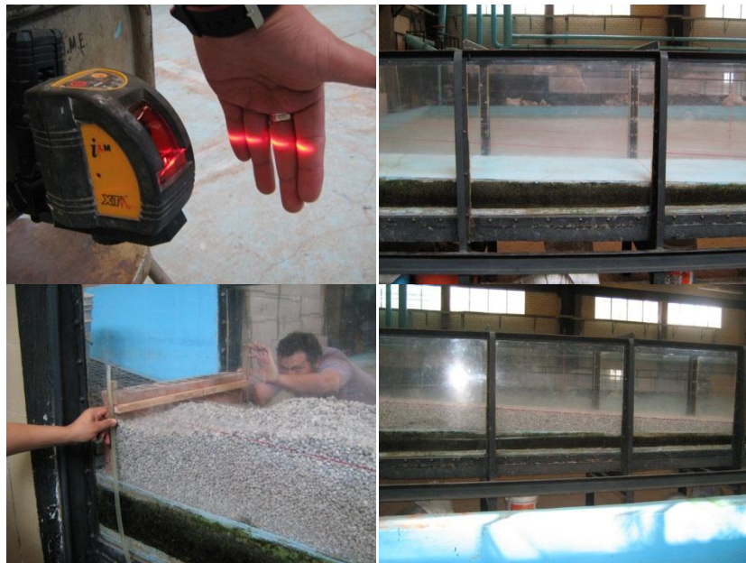
Fig. 5.10. Trazo de la línea de apoyo con nivel láser, relleno, compactación y nivelación.
