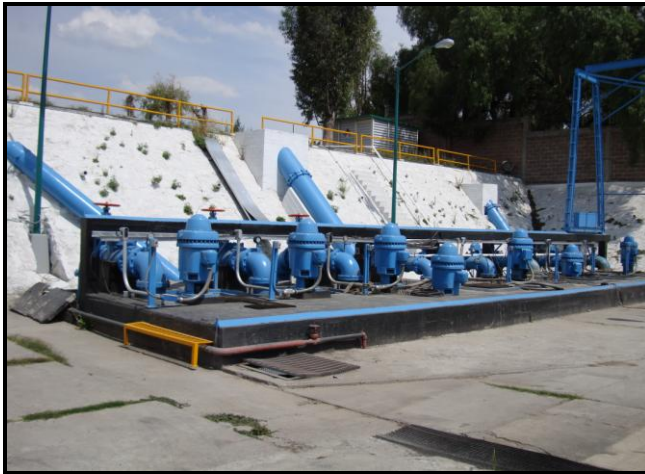
Figura II.4.1 Cárcamos y bombas de agua cruda
