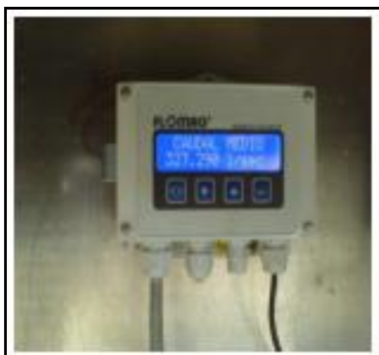
Figura 4. 45.Vista de un medidor de gasto.
