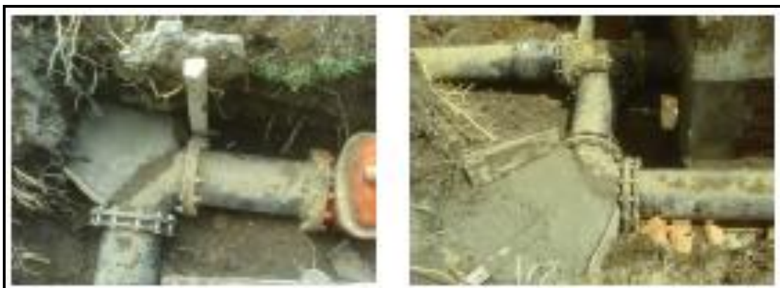
Figura 4. 21. Atracos de concreto en el arreglo hidráulico de la VRP-04.
