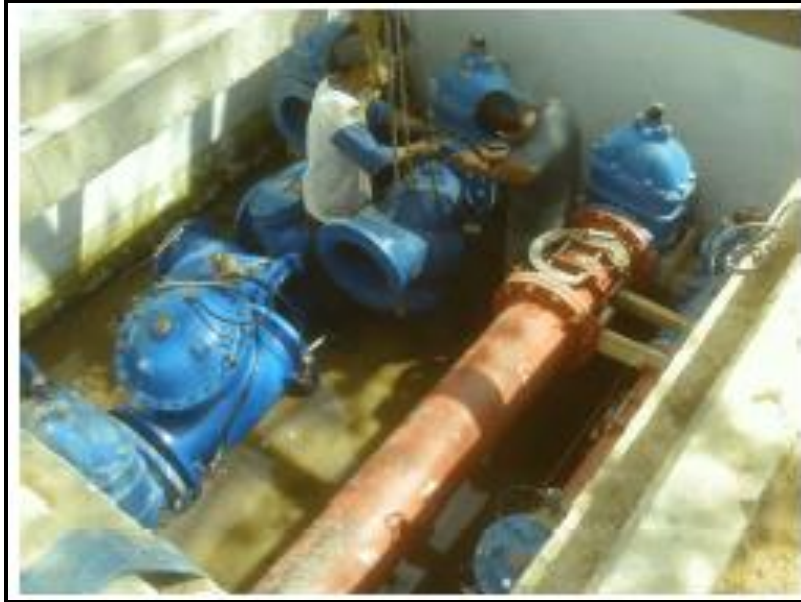
Figura 4. 12.Instalación de VRP, en el sitio de Regulación Manómetros.
