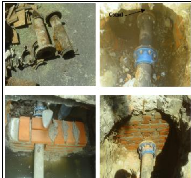
Figura 4. 33. Cancelación de tubería con comal.
