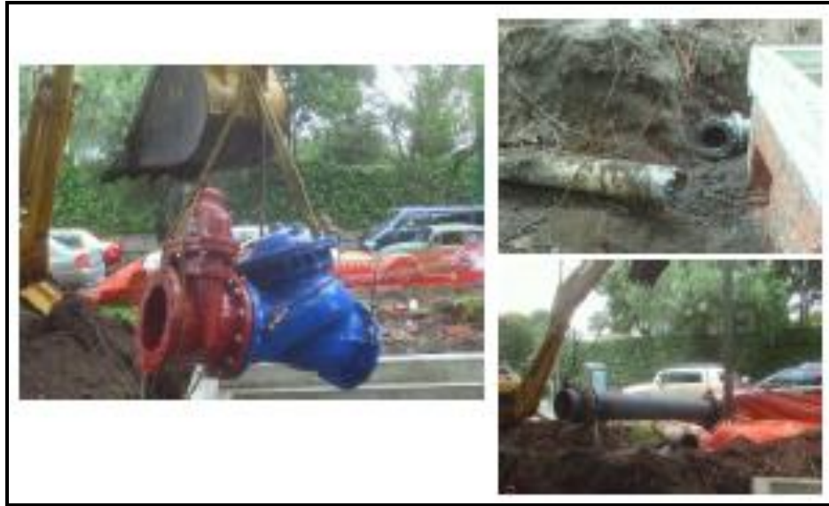
Figura 4. 19. Trabajos y maniobras para la instalación del tren de piezas de la VRP-04
