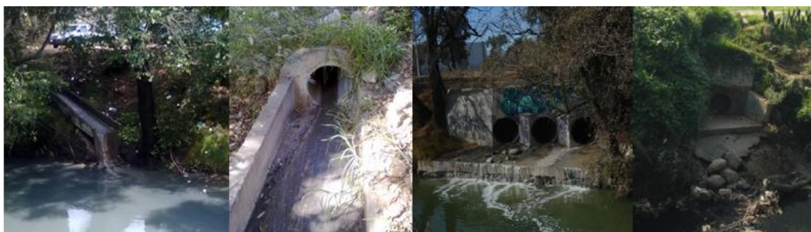
Figura 28. Descargas de Agua residual.
