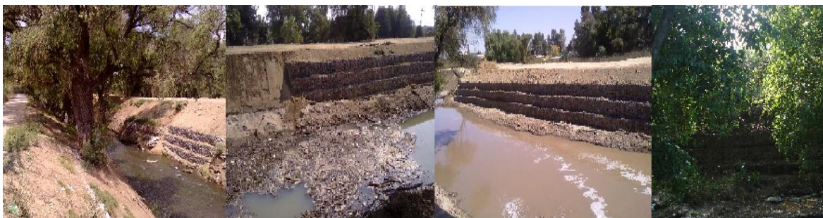
Figura 21. Muros de Gavión. FUENTE. Elaboración propia, 2012.
