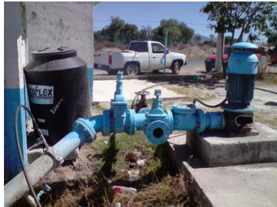
Fig. 13. Detalle del equipo de bombeo existente, con motor eléctrico externo acoplado a bomba de tipo vertical.
