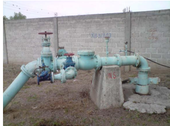
Fig. 10 Detalle del tren de piezas especiales a la salida del equipo de bombeo
