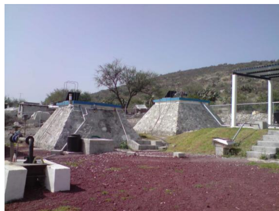
Fig. 18 Tanques de almacenamiento y cárcamo de bombeo.
