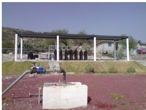
Fig. 15. Detalle del equipo de bombeo existente, con motor eléctrico externo
