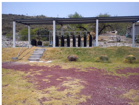
Fig. 16. Planta Potabilizadora a base de filtros.
