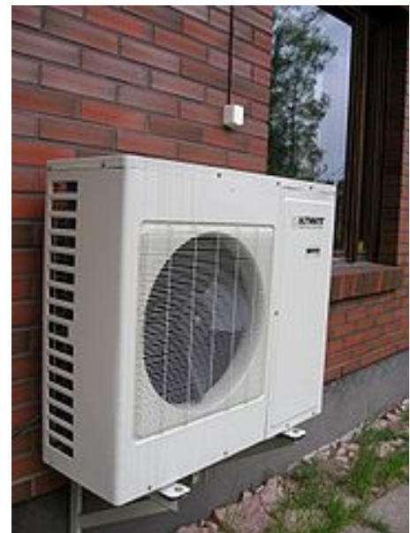
Figura 1. Exterior de un sistema de aire acondicionado moderno (unidad dividida o tipo "split").
