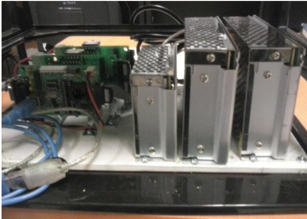
Figura 7.12 Fotografía del gabinete de control.
