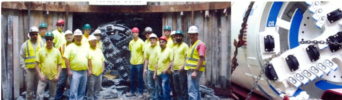
Imagen 2 - 20. Izquierda: El contratista Midwest Mole, Inc. Celebra la llegada de la máquina Rockhead de doble escudo en el otoño de 2011. Derecha: La máquina Robbins excavó cinco túneles, incluyendo un record de perforación de 614 m, con una rueda de corte para tierra mixta.
