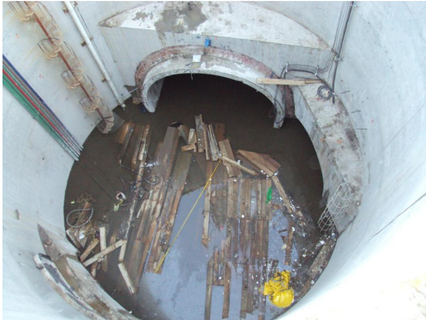
Imagen 5 - 4. Inundación en la Lumbreira 0.
