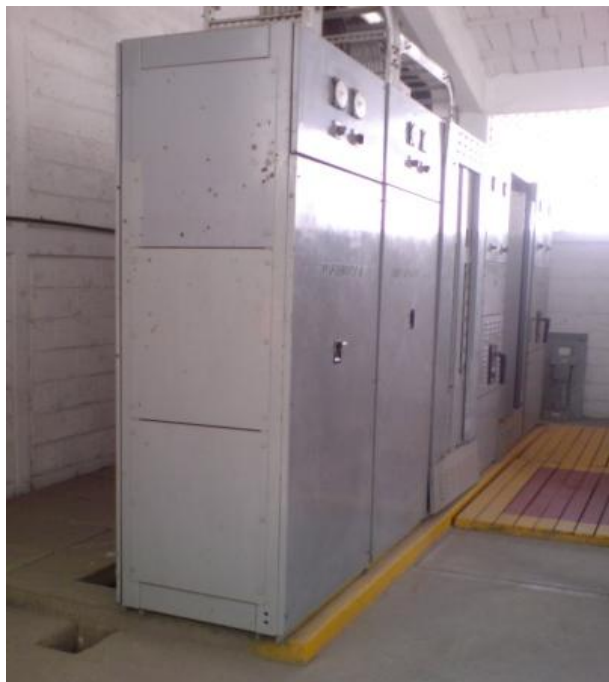
Figura No. 18 Tableros eléctricos.
