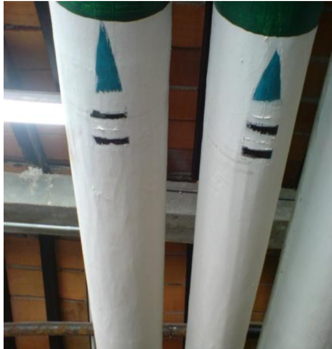
Figura No.17 Tuberías de retorno de agua helada.
