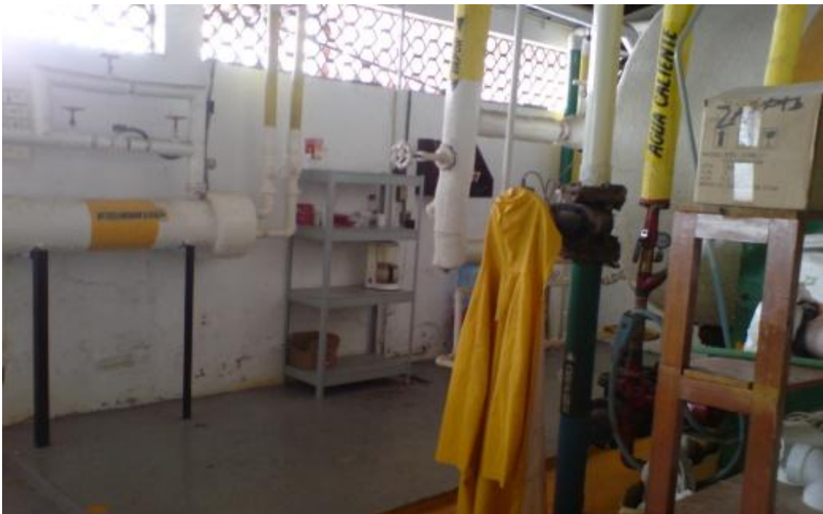
Figura No.16 Base para la instalación e intersección con los actuales servicios.
