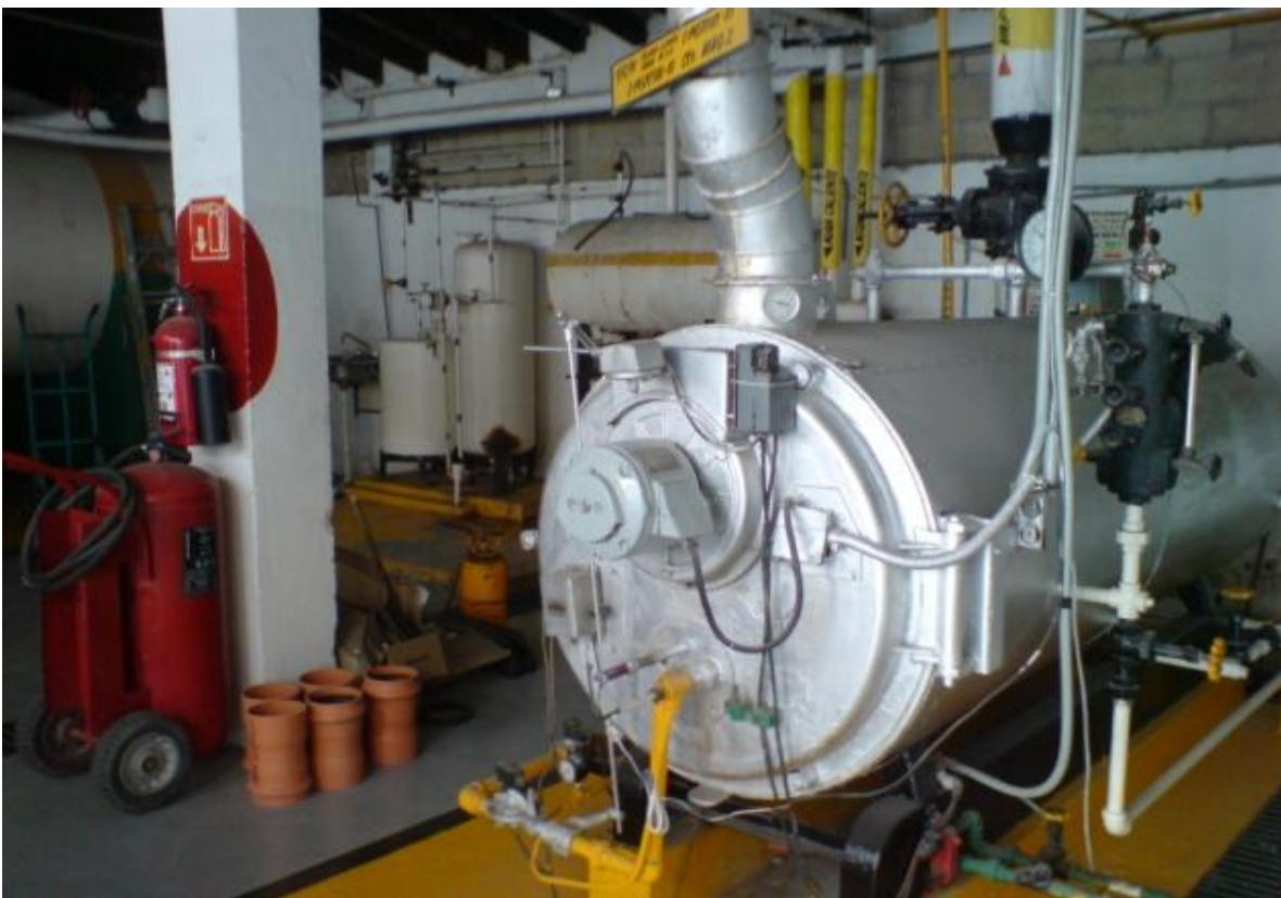
Figura No. 13 Caldera actual Hotel Antigua Hacienda Vallarta.
