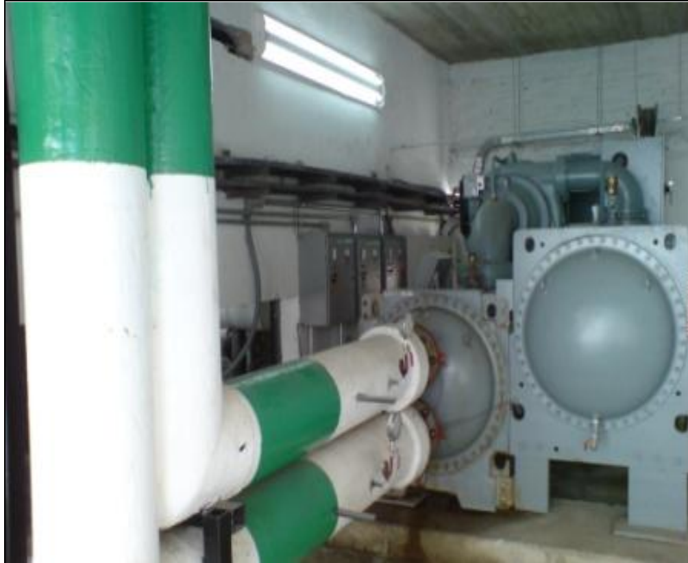
Figura No. 15 Equipo centrífugo de refrigeración hotel Antigua Hacienda Vallarta.
