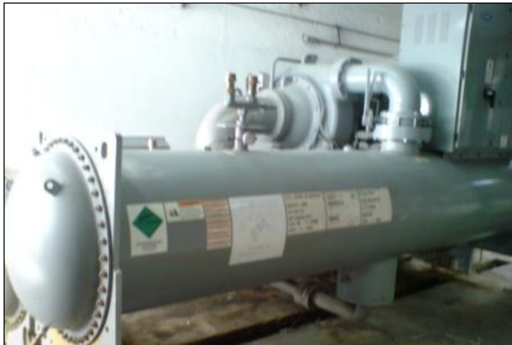
Figura No. 14 Equipo centrífugo de refrigeración hotel Antigua Hacienda Vallarta.
