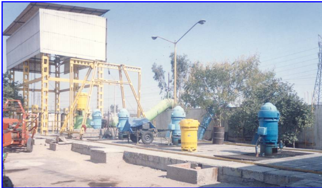
Fig No 2.1.5. CARCAMO DE BOMBEO.
