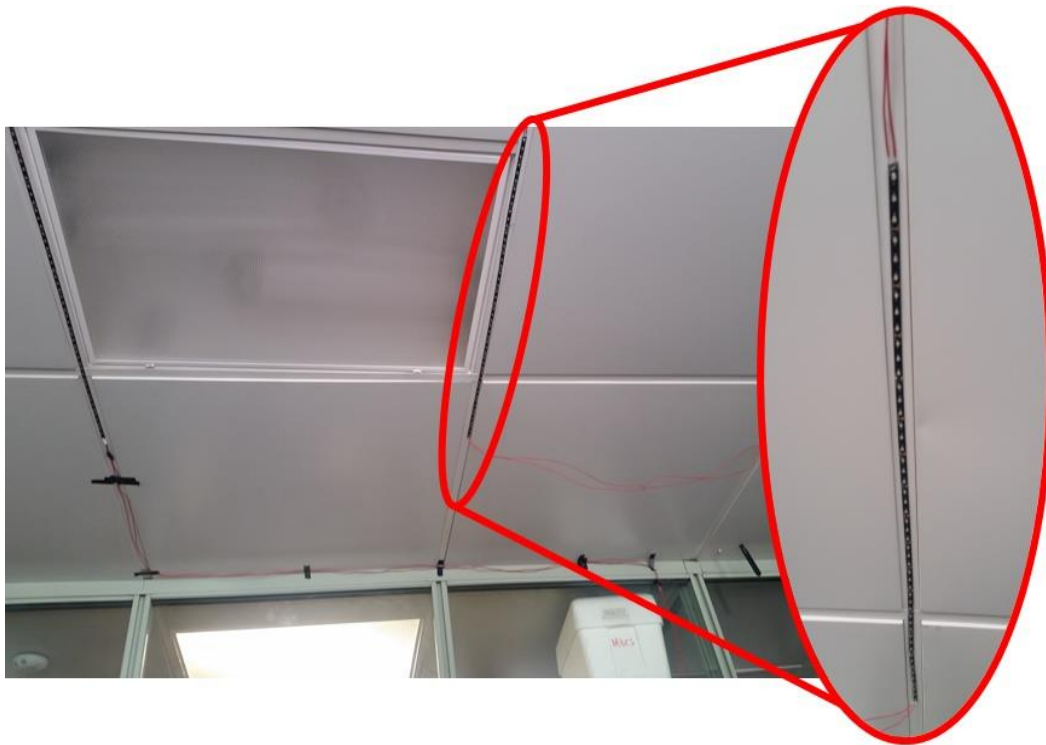
Figura 3.16 Leds en baja carga de la batería.
