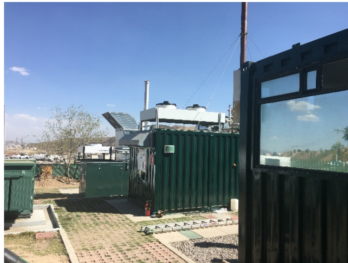
Figura 36. Instalaciones Planta de Biogás Energreen Atizapán. Año: 2018
