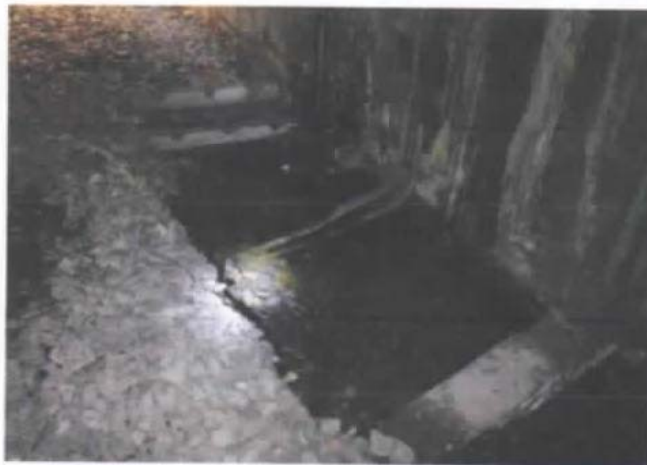
IMAGEN 22 ENCHARCAMIENTO EN EL BALASTRO
