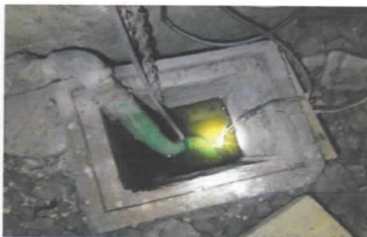
IMAGEN 23 BOMBA AUXILIAR PROVISIONAL
