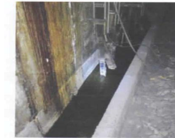
IMAGEN 21 TRINCHERA DE CABLES INUNDADA
