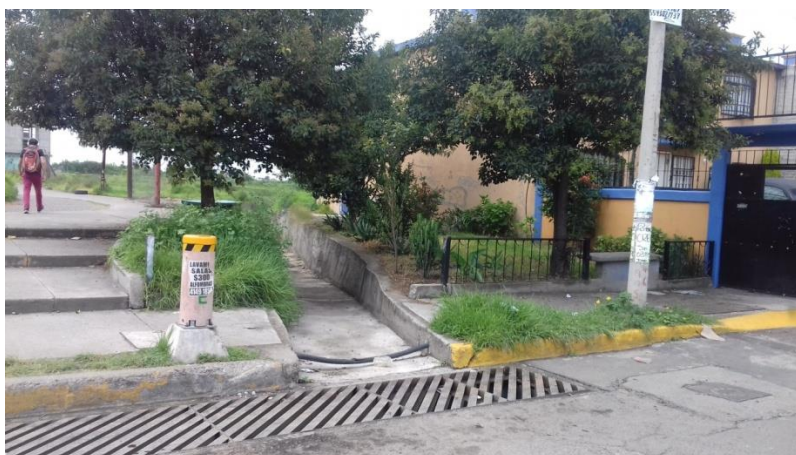
Imagen 13 Vista de una canalización de agua para el vaso regulador
