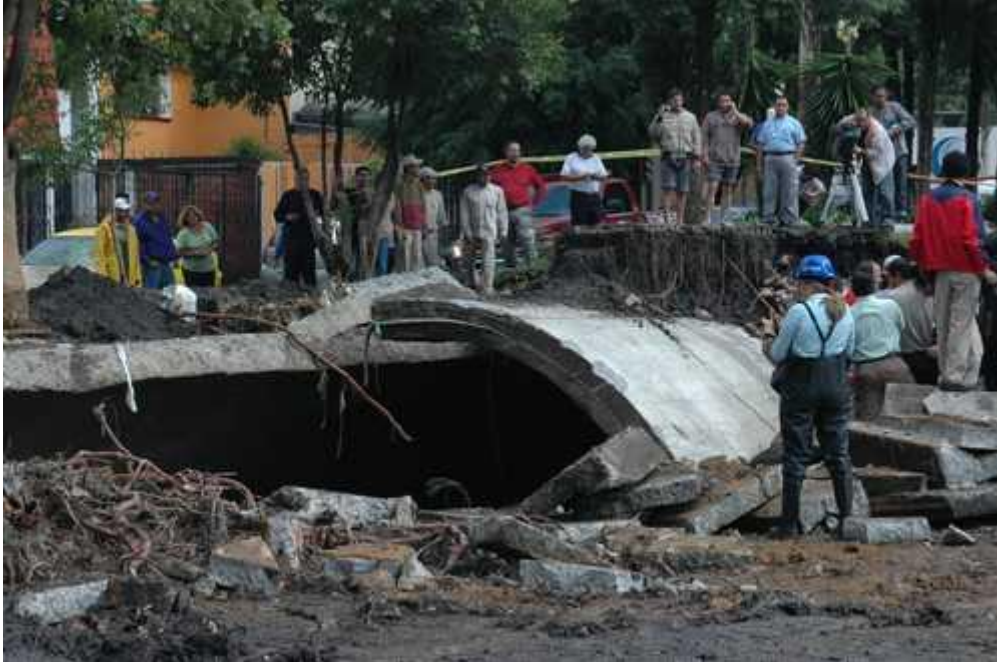
Imagen 4 Colapso de 25 metros del Emisor Poniente en Valle Dorado
