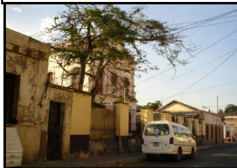
Fotografía 21: Casa en deterioro
