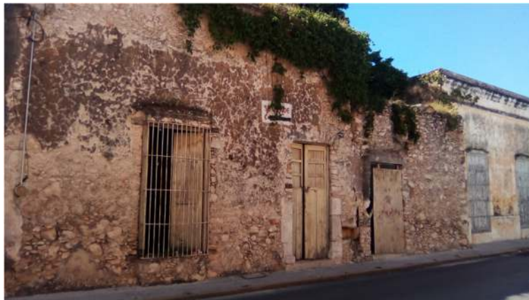
Ilustración 7 Deterioro de vivienda. Foto: H.N.M. (2018)
