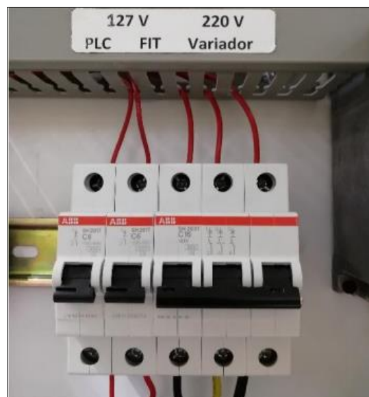
Figura 2-14 Interruptores termomagnéticos para protección [13].
