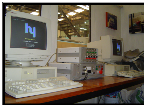
Fig. 4.4.1 Equipo de cómputo para control del generador y de medición de oleaje.
