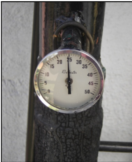
FIGURA 7-8. Temperatura de retorno de los colectores hacia la alberca. Cortesía UDLA.
