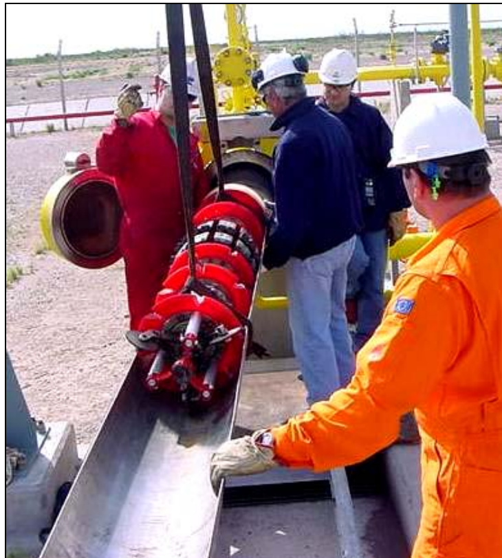
Figura I.1. Lanzamiento de equipo instrumentado para la inspección de un sistema de ductos.
