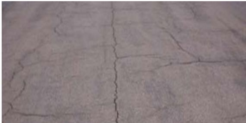
Figura 3. 10 Agrietamiento en retícula.
