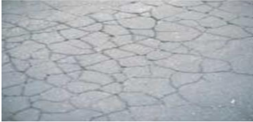
Figura 3. 11 Agrietamiento en malla cerrada.
