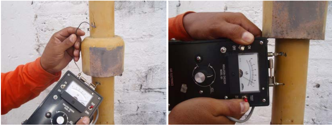
Fig. 118.- Revisión de Junta Monoblock con equipo probador de continuidad (De izquierda a derecha, Foto1: comprobación de aislamiento eléctrico; Foto 2: prueba de funcionamiento del equipo)
