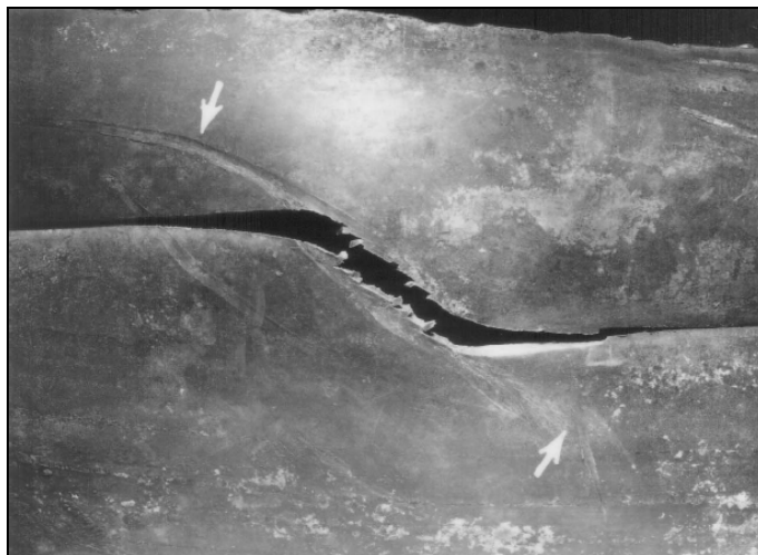
Figura 1.- Abolladura con protuberancia
