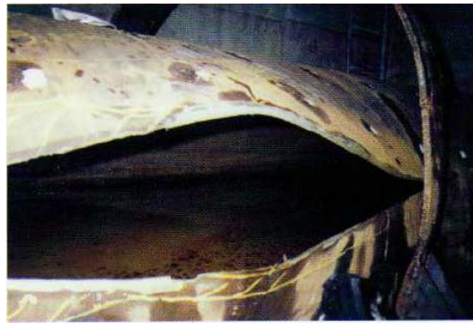
Figura 66.- Fractura por presurización de tubo
