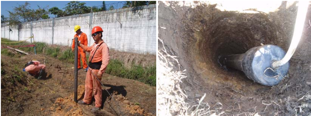
Fig. 110.- Conexión de cama anódica a base de ánodos inertes de Grafito (De izquierda a derecha, Foto1: Preparación de agujeros; Foto 2: ánodo conectado)
