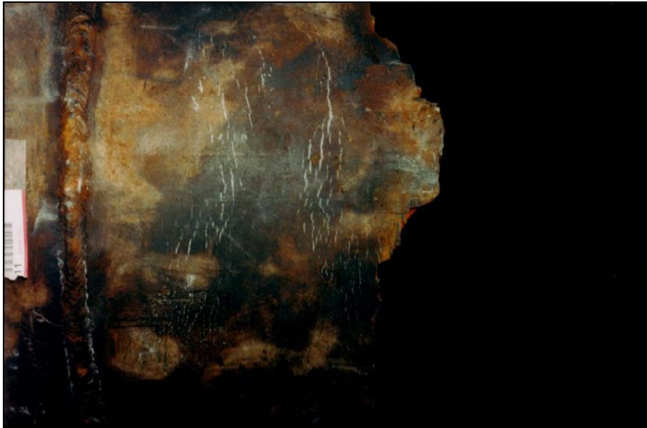
Figura 7.- Agrietamiento intergranular debido a corrosión con esfuerzo
