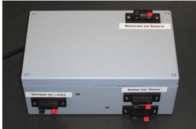
Fig. 6.20: Exterior del medidor de ángulo de carga final instalado en un gabinete. Las diferentes conexiones de los transductores y de la salida se indican en la figura.
