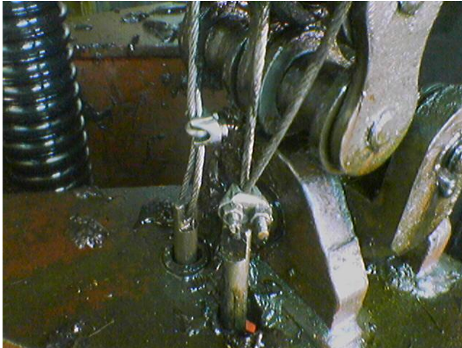
FIG.2.23. Seguros de apoyo en el anclaje de las cadenas de elevación.
