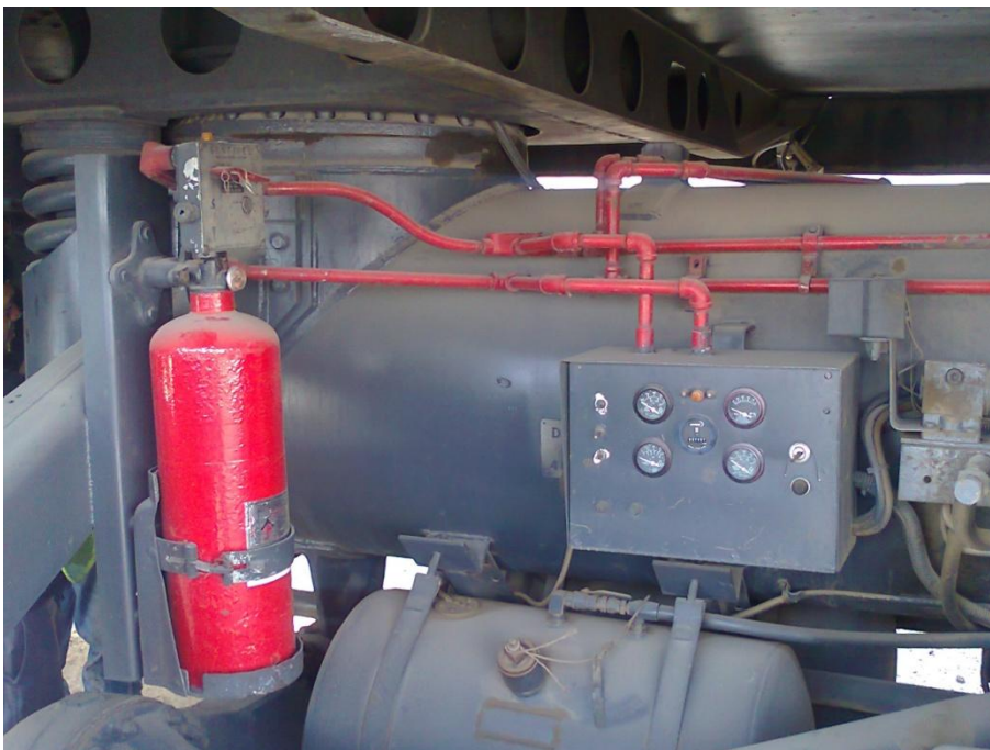
FIG.1.14. Manómetros de presión del depósito de extintor y depósito de agente extintor tipo ABC.
