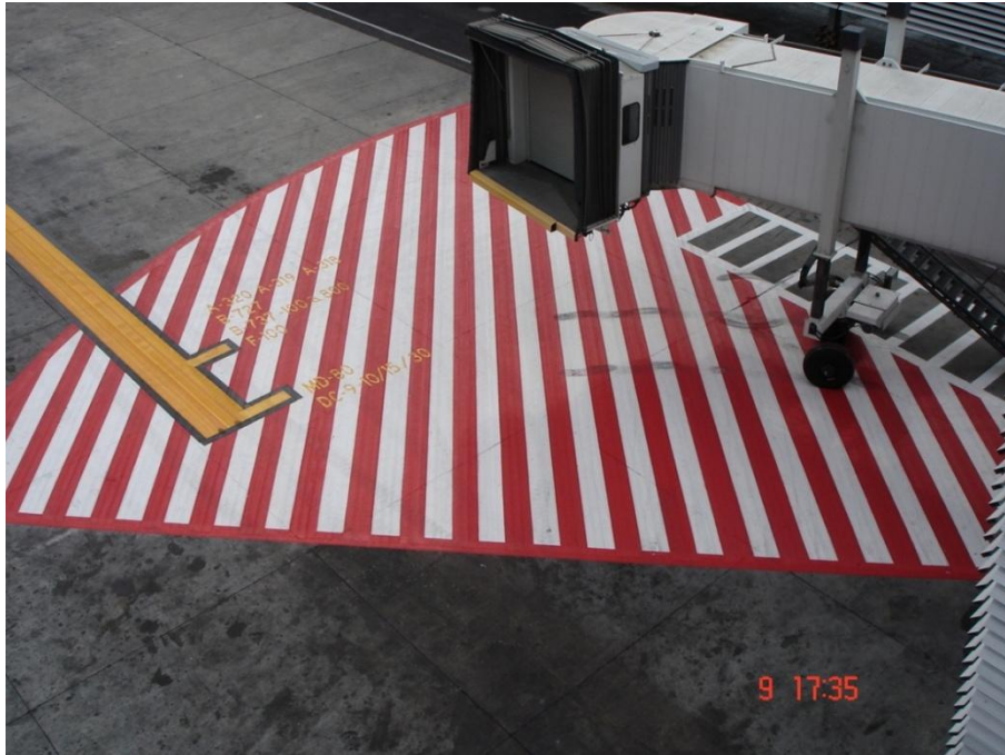
FIG.1.14. Pasillo Telescópico y su marcaje de seguridad en franjas rojo y blanco. En amarillo el peine de atraque de aeronaves con las indicaciones por tipo de aeronave a estacionar.
