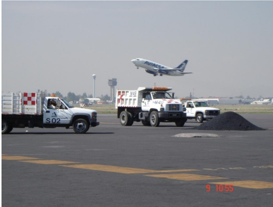
FIG.1.58. Las actividades de repavimentación y rehabilitación del área operacional pueden generar desechos de riesgo para la seguridad operacional.
