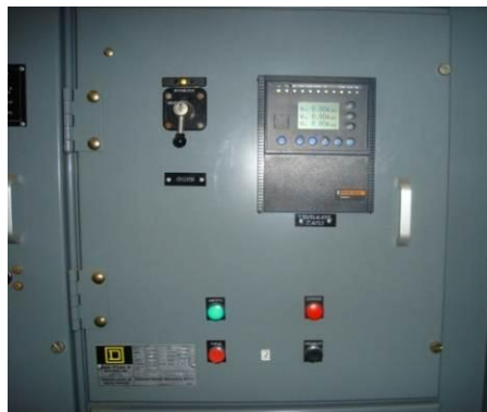
Figura 1.8 Tablero de control.
