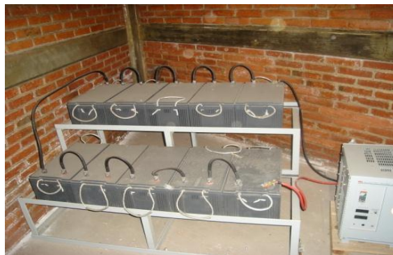
Figura 1.9 Mesa de baterías para generar corriente continua y protección de los tableros de control.
