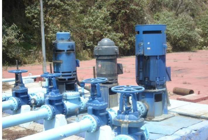
Figura 1.11 Bombas verticales empleadas en la planta de bombeo.
