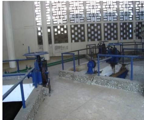
Figura 1.12 Instalaciones de la trifurcación.
