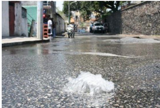
Figura 1.2. Fuga de agua en el DF.
