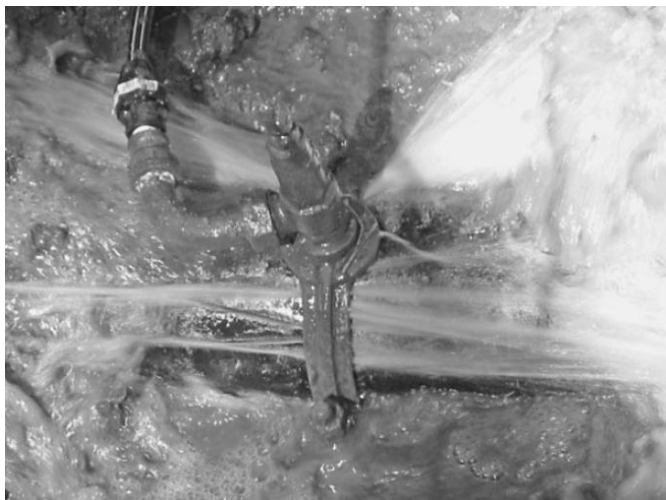
Figura 1.6. Fuga en tubería de servicio.
