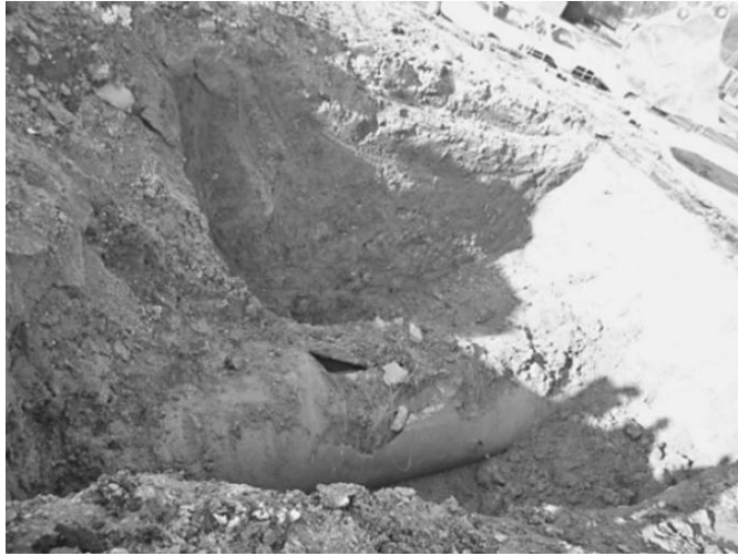
Figura 1.4. Ruptura en una tubería de transmisión principal.
