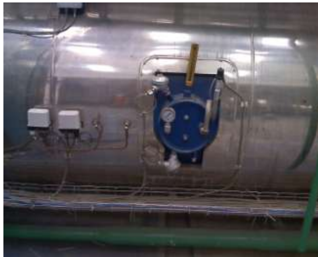
Fig. 2.12 Instrumentación en la caldera de proceso de la autoclave.
