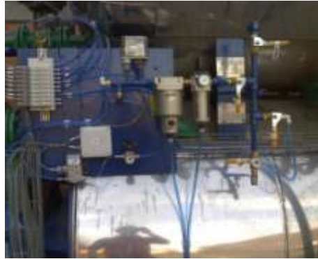
Fig. 2.8 Elementos neumáticos de la autoclave
