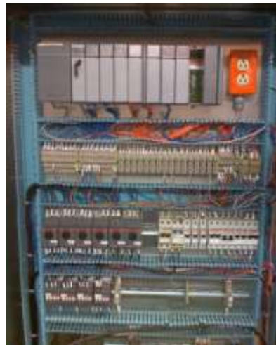
Fig. 3.21 Cableado del tablero de control
