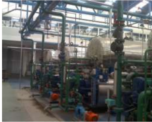
Fig. 3.23 Circuito de agua fría que viene de las torres de enfriamiento hacia las autoclaves.
