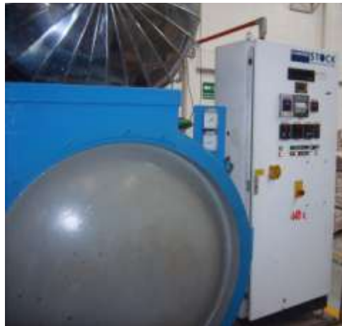
Fig. 1.1 Tablero eléctrico de la autoclave antes de la automatización.
