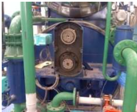
Fig. 2.3 La transmisión de la autoclave para mover el tambor.
