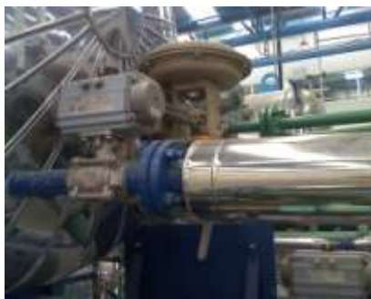
Fig. 2.9 Válvulas de la autoclave.
