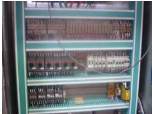
Fig. 2.13 Componentes eléctricos tablero autoclave.
