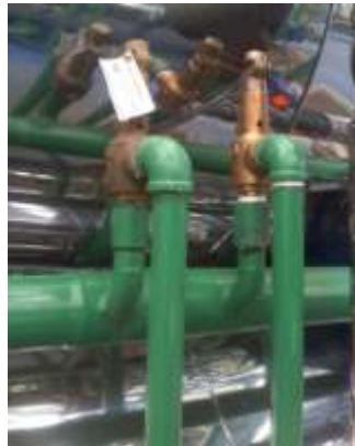
Fig.2.10 Válvulas de seguridad en la autoclave.
