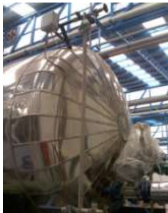
Fig. 3.26 Caldera de almacenamiento y sensor de nivel.
