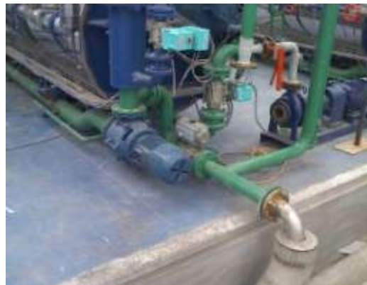
Fig. 3.22 Circuito de drenaje de agua de las autoclaves hacia las cisternas
