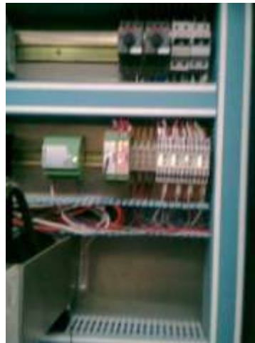
Fig. 3.24 Tablero de control sistema de bombeo de agua caliente en la cisterna.
