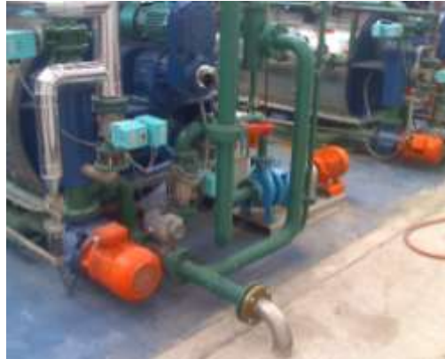
Fig. 2.4 Bombas en la autoclave.
