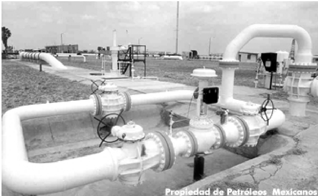
Fotografía 7: Gasoducto perteneciente a Gas y Petroquímica Básica
