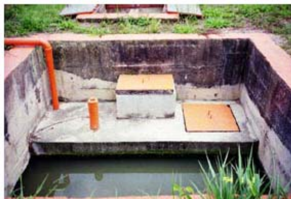
Planta tratadora de aguas
