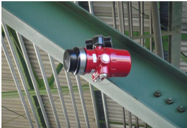
Figura 4.24 Detectores de fuego instalados en casa de bombas.
