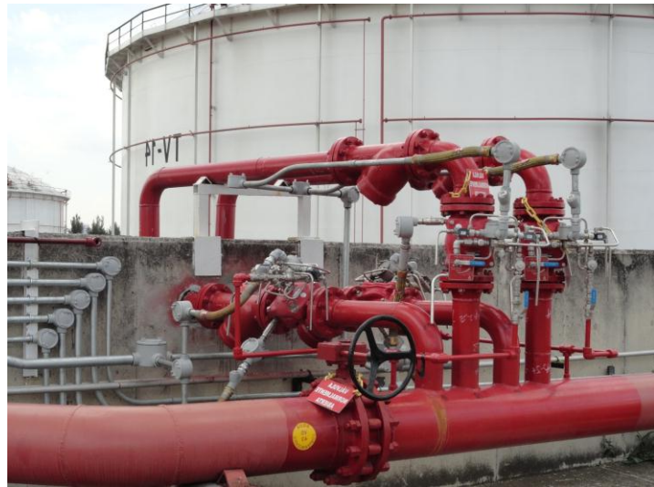
Figura 4.29 VOS instaladas para la red de agua contra incendio.
