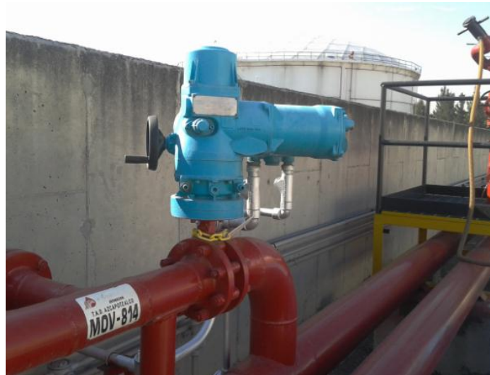
Figura 2.16 Válvula Operada Eléctricamente.
