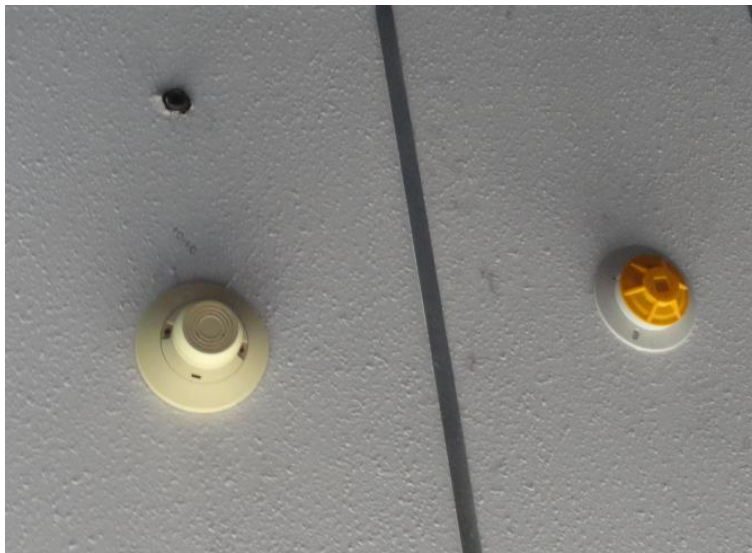
Figura 4.22 Detectores de humo instalados en áreas de oficinas.
