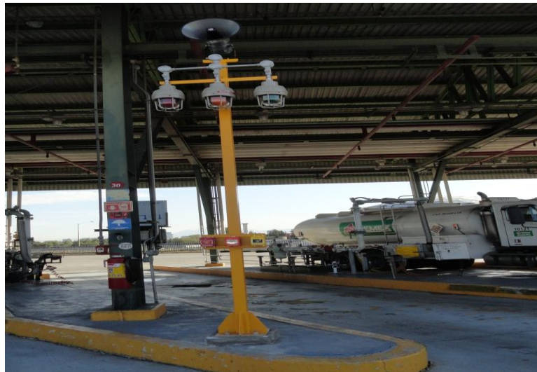
Figura 4.28 Alarmas sonoras y visuales instaladas en el área de llenaderas.
