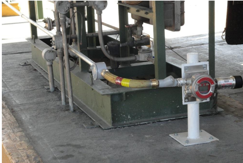
Figura 4.27 Detectores de mezclas explosivas en el área de llenaderas.
