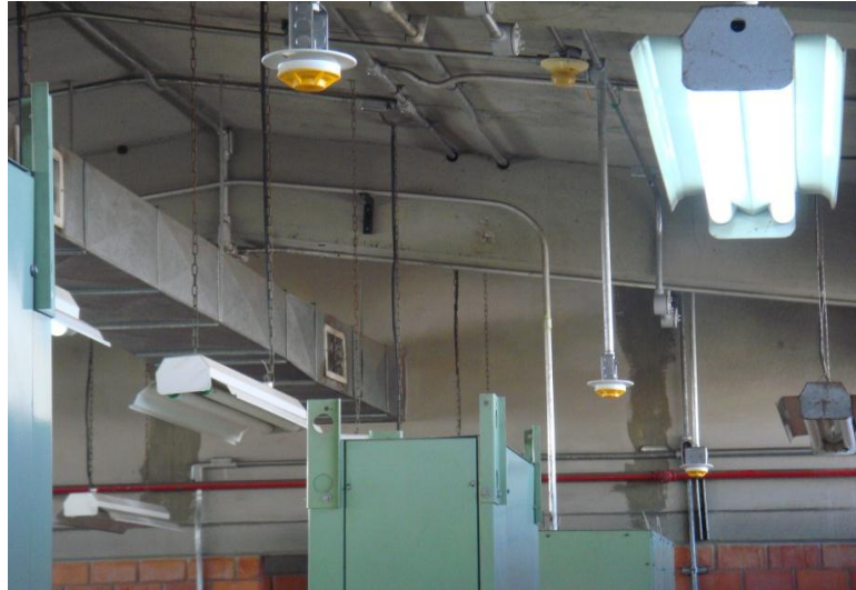
Figura 4.24 Detectores de humo instalados en CCM.
