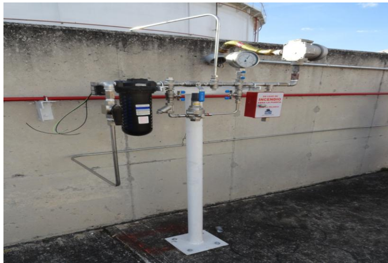
Figura 4.26 TRIM instalado a pie de dique de cada TV.
