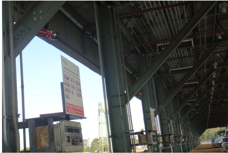
Figura 4.25 Detectores de fuego instalados en el área de llenaderas.
