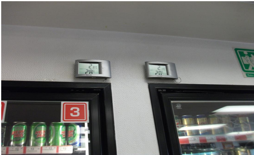
FIGURA 3.2 VERIFICACIÓN DE LAS LECTURAS DE TEMPERATURA EXTERIOR E INTERIOR DE LA CÁMARA.
