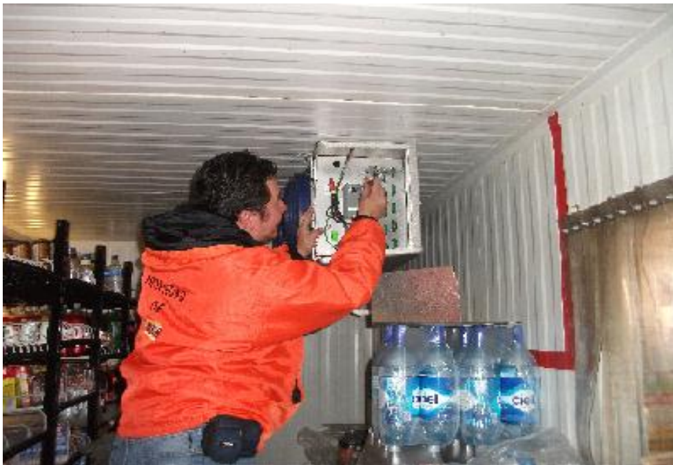
FIGURA 3.20 AJUSTE DEL CONTROL DE TEMPERATURA EN EVAPORADORA.
