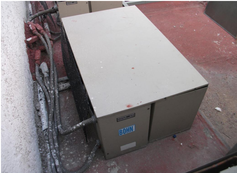
FIGURA 3.3 LOCALIZACIÓN DE LAS UNIDADES CONDENSADORAS DE LA CÁMARA FRIA.
