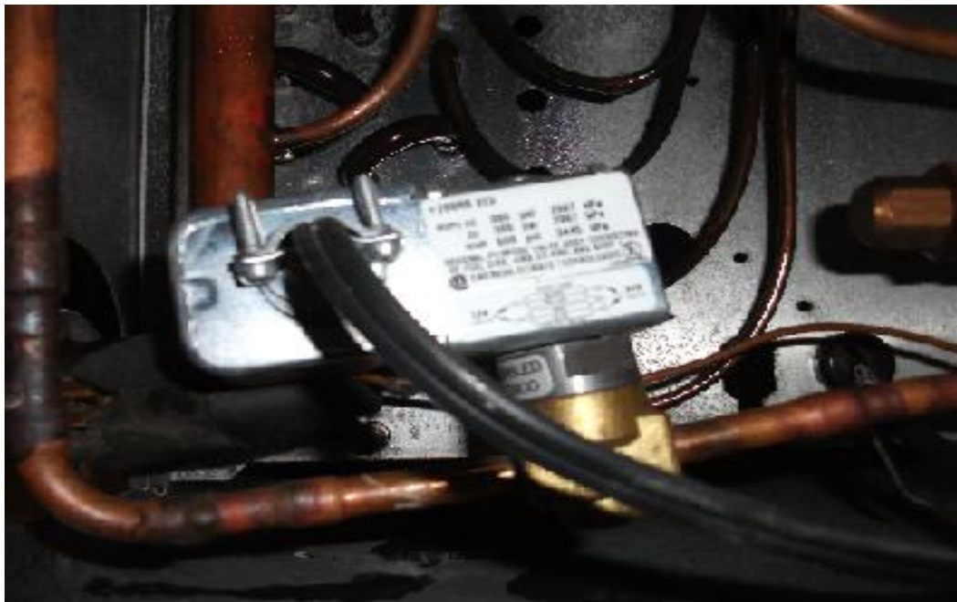
FIGURA 3.21 REVISIÓN DEL FUNCIONAMIENTO DE LA VÁLVULA SOLENOIDE.
